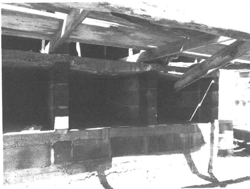
FUGA DA ALVENARIA MAL EXECUTADA
