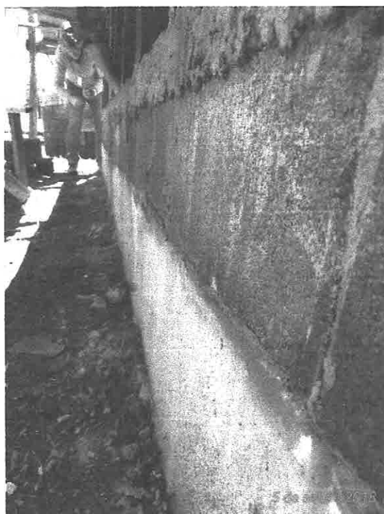
FUGA DA ALVENARIA MAL EXECUTADA
