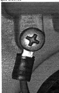
Conexão de aterramento
