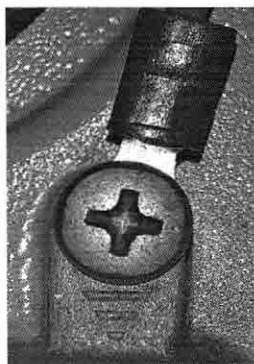
Conexão de aterramento
