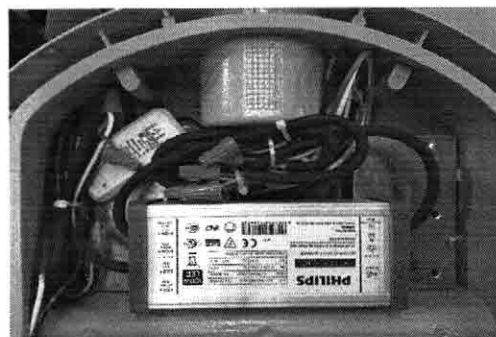
Fiação interna da luminária
