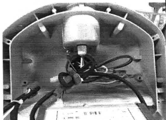
IP6X - Evidência de NÃO Ingresso de pó no alojamento do controlador
