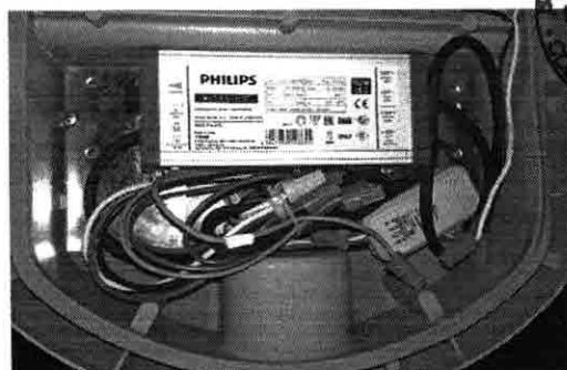
Fiação interna da luminária
