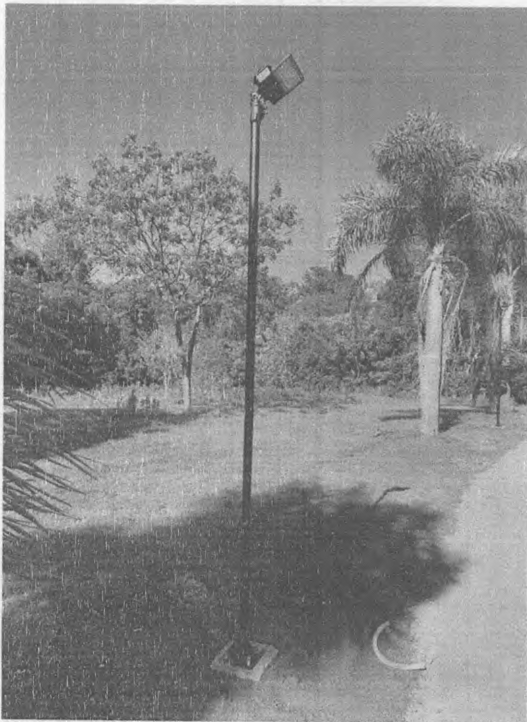
Foto 01 : Luminária na cor preto da marca ESB instalada no lago municipal de Coronel Vivida.
