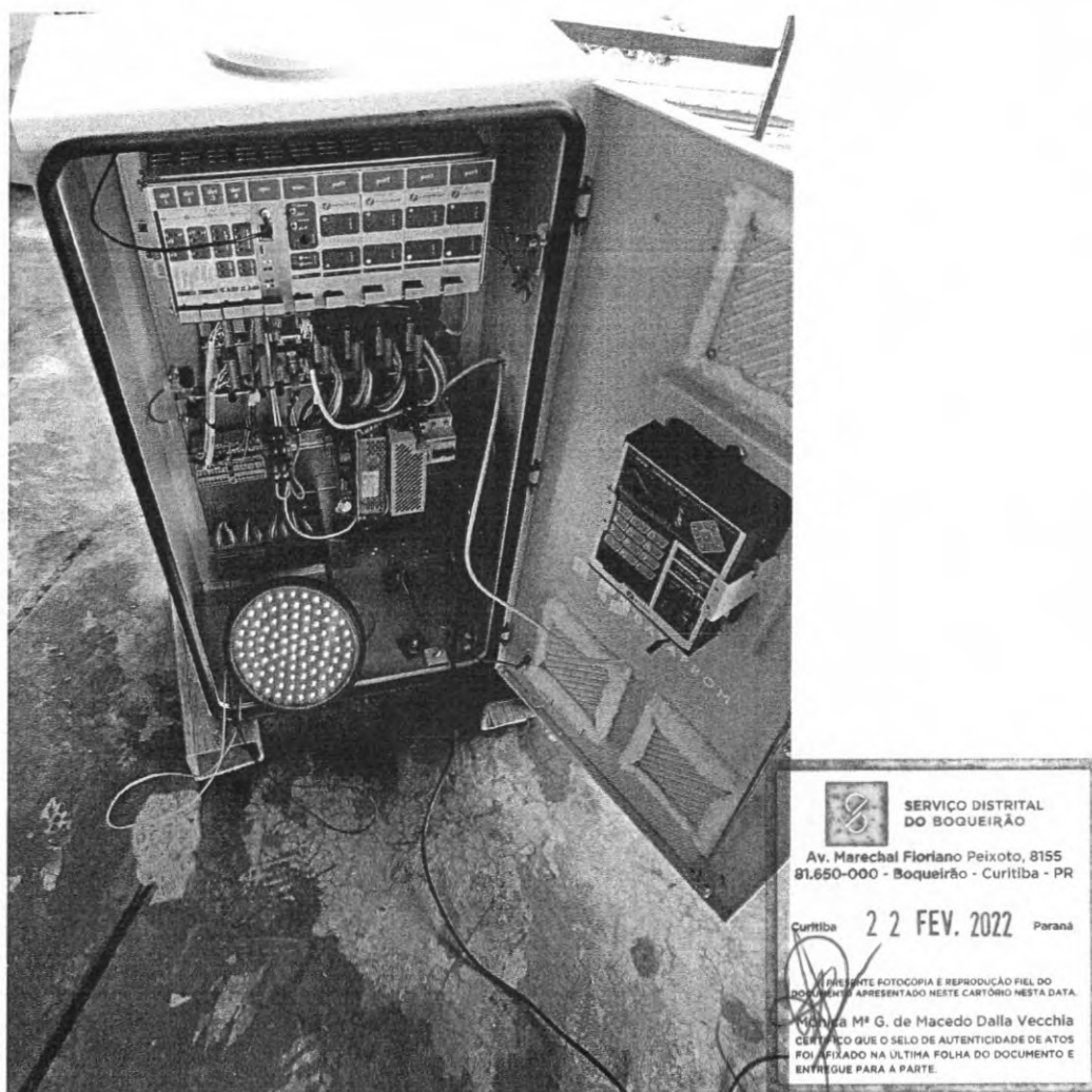
Figura 12 – Amostra após os testes de verificação de proteção contra água - Verificação Funcional.
