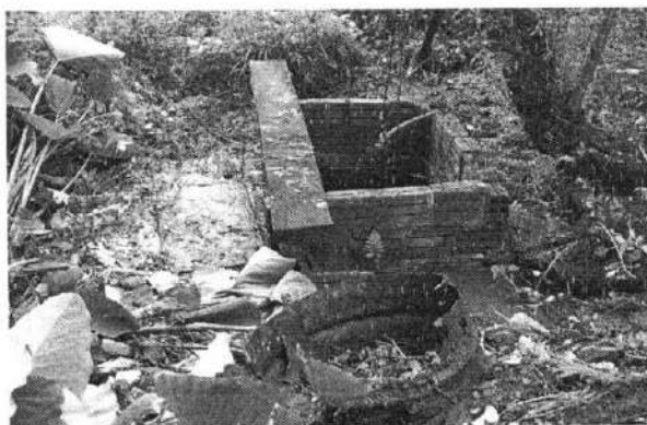
Figura 14 - Sistema antigo de captação
