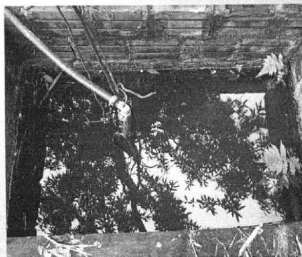
Figura 16 - Captação inadequada em nascente assoreada.
