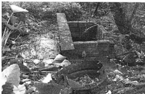
Figura 14 - Sistema antigo de captação
