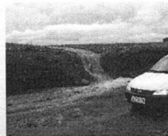
Figura 5 - Enxurrada destruindo estrada
