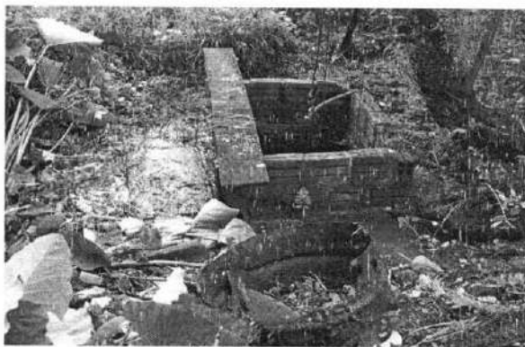
Figura 14 - Sistema antigo de captação
